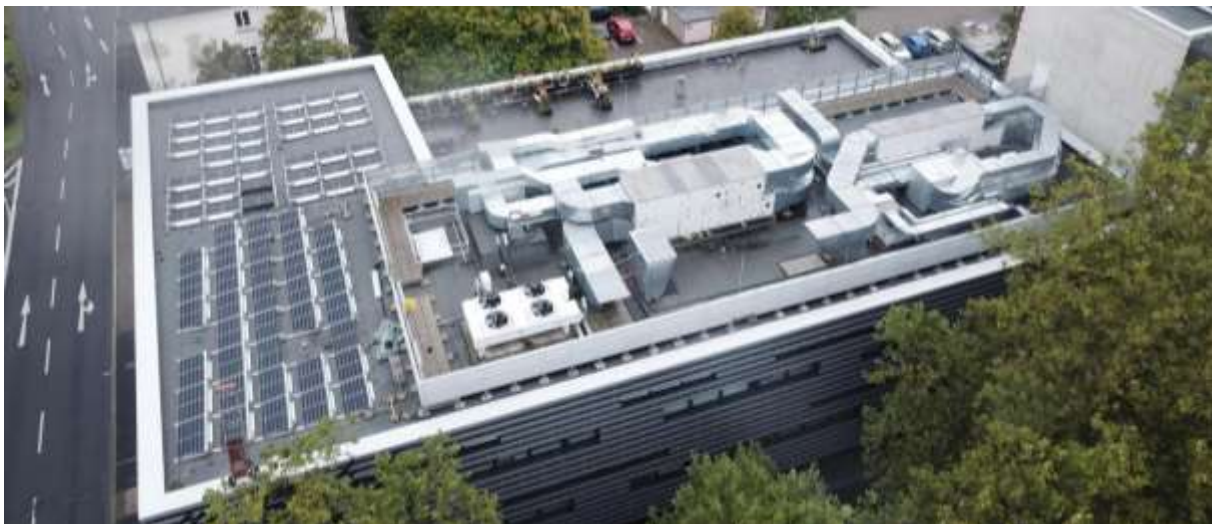
Abb. 79: Technische Komponenten auf der Dachfläche des Gebäudes HC
