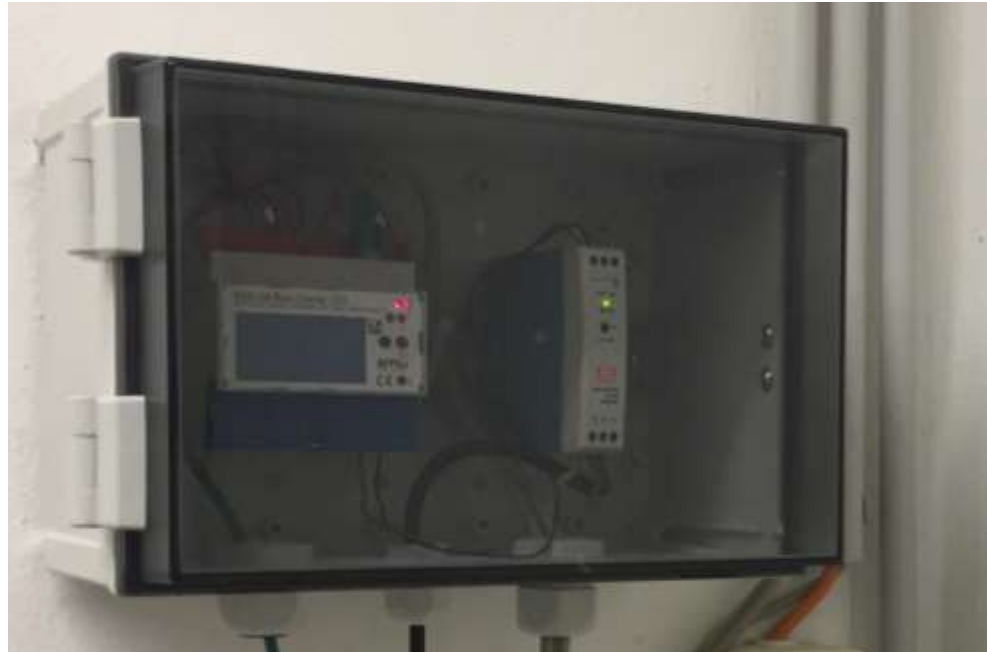
Abb. 18: EMU M-Bus Center 250 in Betrieb in der Jugendherberge Hormersdorf; Quelle: Eigene Aufnahme; 27.03.2017
